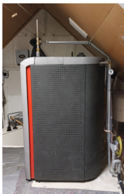
Installatievoorbeeld op een zolder
