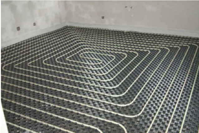
Figuur 3.8 Vloerverwarming gelegd volgens het 'slakkenhuis-patroon', wat een gelijkmatige vloertemperatuur tot gevolg heeft
